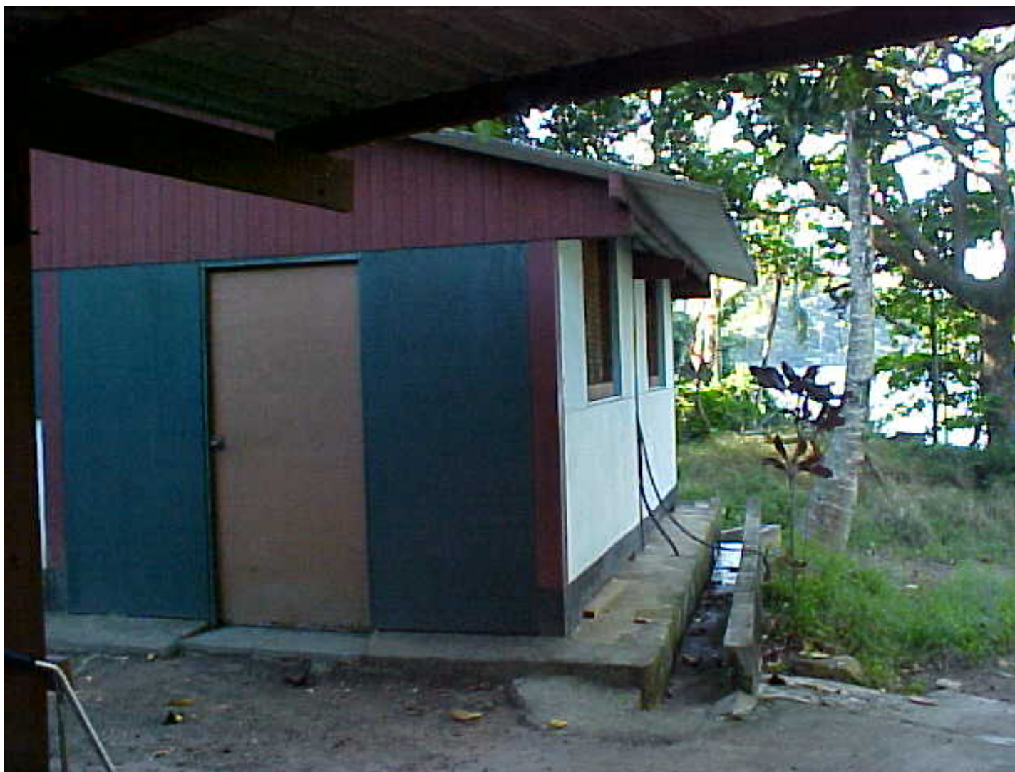
CANALETA JUNTO AO SS17-LABORATÓRIO
