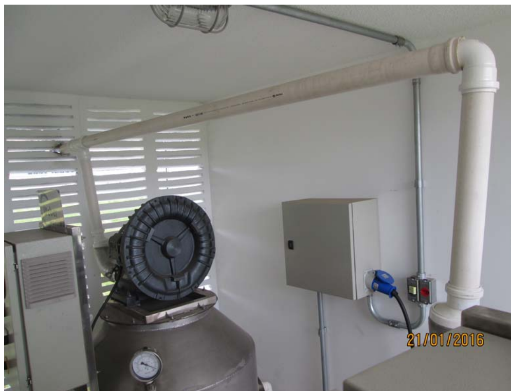
Figura 4.2.2 Foto do Detalhe da tubulação de saída de ar
