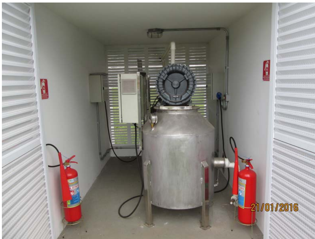
Figura 4.2.1 Foto do Exaustor no "Abrigo Auditórios"
