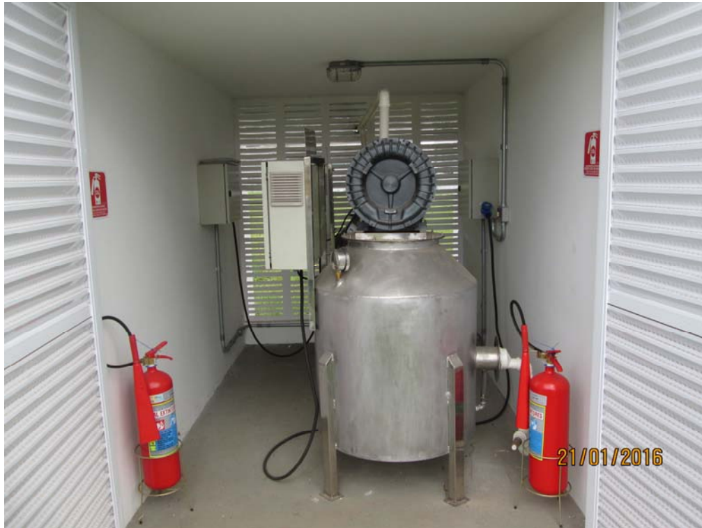
Figura 4.2.1 Foto do Exaustor no “Abrigo Auditórios”
