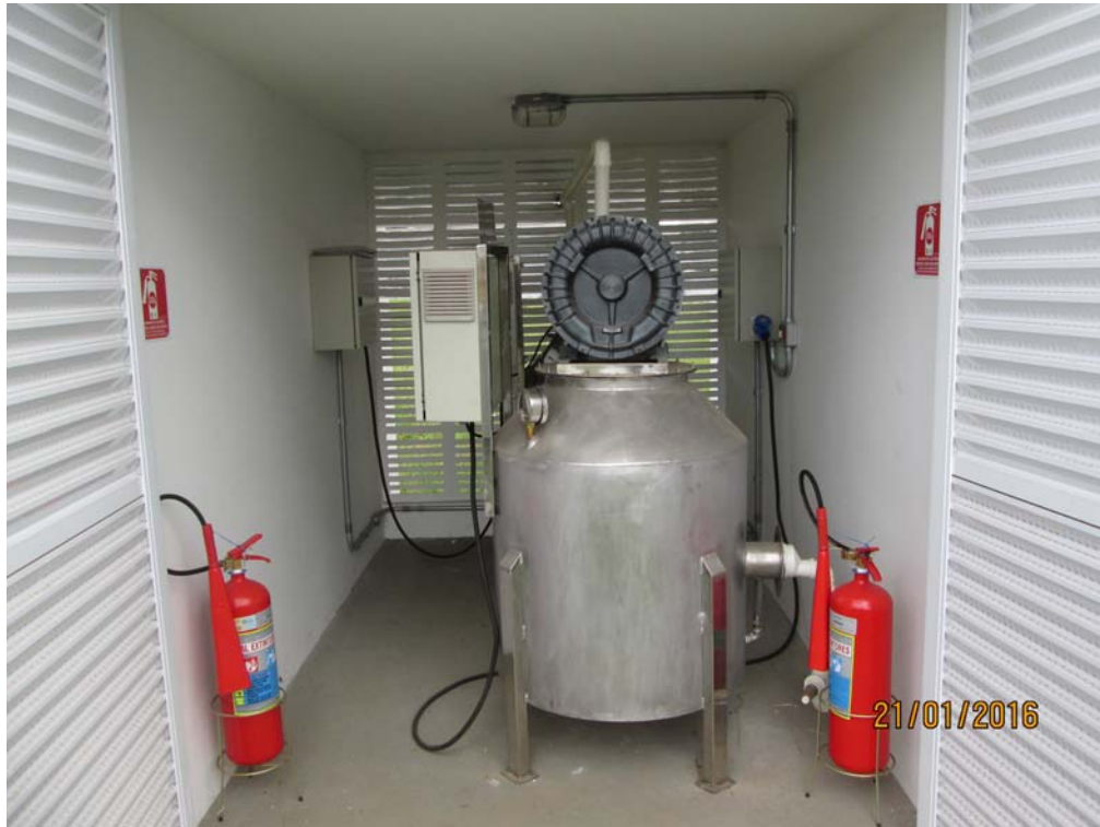
Figura 4.2.1 Foto do Exaustor no “Abrigo Auditórios”
