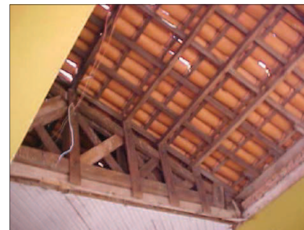
Figura 66 - Edifício da Arquibancada - Problemas na cobertura Set 2006
