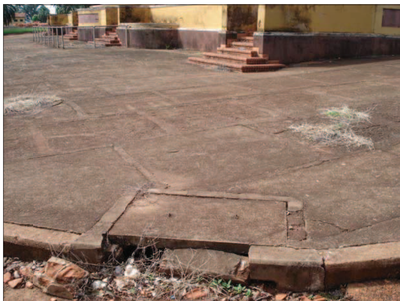
Figura 55 - Drenagem obstruída junto ao edifício da Arquibancada Fev 2008
