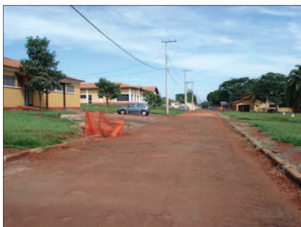
Figura 119 - Boca de lobo avariada em frente ao Laboratório de Saúde Animal - Via com proposta de nova pavimentação Fev 2008
