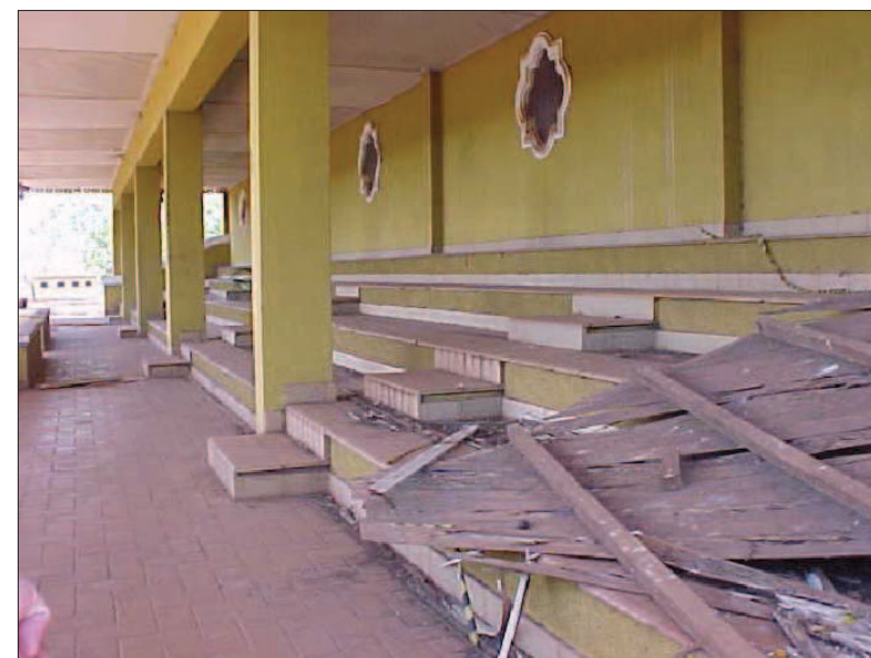
Figura 60 - Forro caído no edifício da Arquibancada Set 2006
