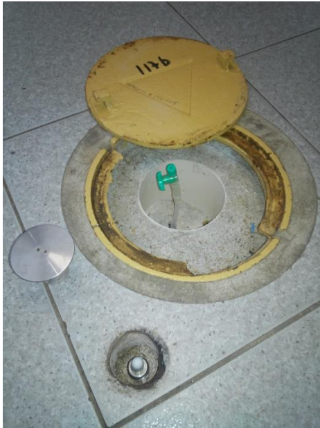
Poço de Monitoramento de Gás Acima: PMG-A (Vapor Pin™); Abaixo: PMG-B (Profundo)
