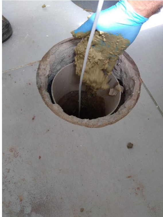
Foto 05 – Selagem da sondagem com calda de bentonita do poço com filtro de pedra porosa, instalado na zona não saturada
