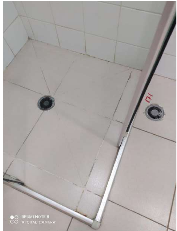
Fotografia 19. Ralo 171 sem identificação dentro do box e ralo 177 identificado como 171
